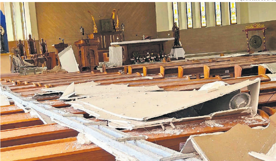
Terremoto em Nusa Tenggara Oriental, na Indonésia, causa danos em igreja, dia 15
